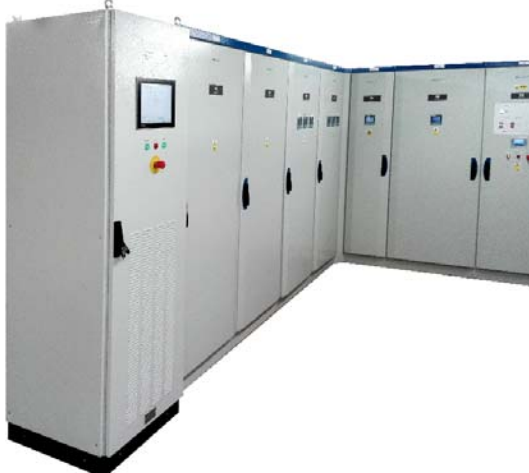
FILTR AKTYWNY O MOCY 2 MVA
